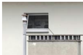
Le câble d'alimentation atteignant la prise
