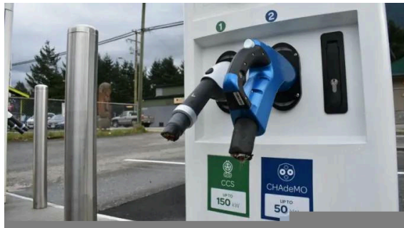
Station de recharge de véhicules électriques dont les câbles ont été sectionnés.
