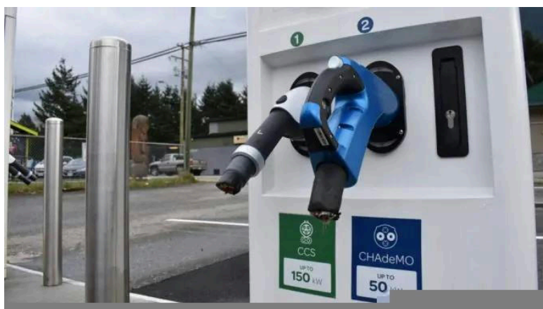
Station de recharge de véhicules électriques dont les câbles ont été sectionnés.
